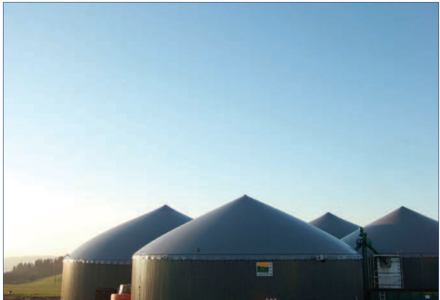
Beispiel für eine Biogasanlage; Foto: www.oekostrom-saar.de
