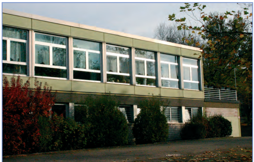
Abb. 5.1, sanierungsbedürftiges öffentliches Gebäude
